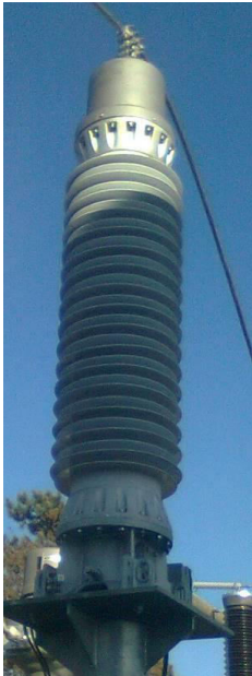
Slika 7 – Naponski transformator 110 kV sa otvorenim magnetnim kolom
