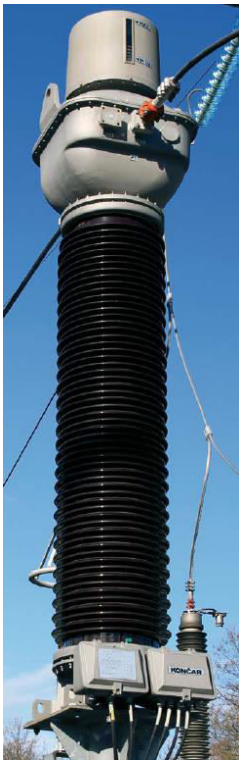
Slika 10 – Kombinovani strujno-naponski transformator 110 kV
