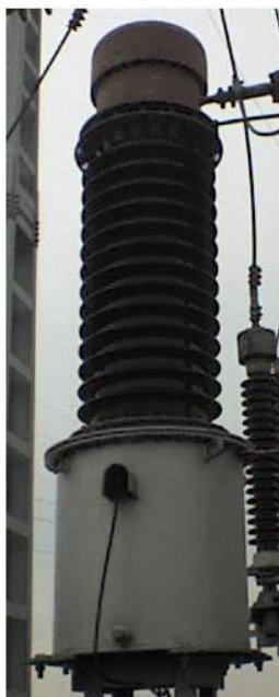
Slika 6 – Naponski transformator 110 kV sa gvozdenim sudom u donjem delu
